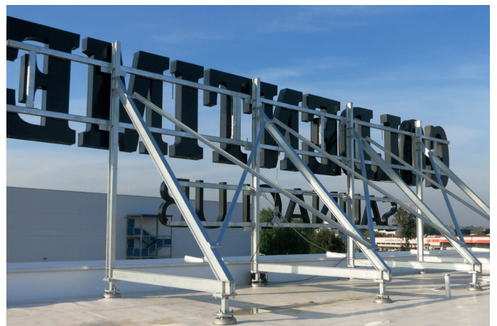
Werbeanlagen, Haustechnik etc.
